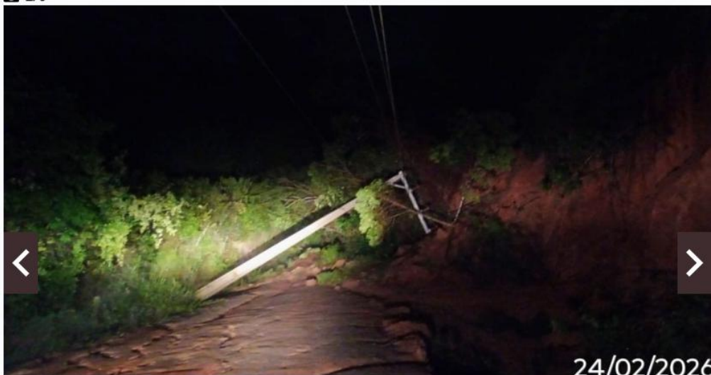
Poste de energia caiu durante noite chuvosa (Foto: Defesa Civil, Reprodução)
