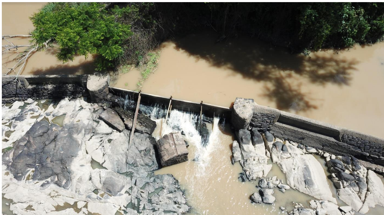
Figura 5 – Vertedouro e Barramento 3 da UHE Salto Weissbach
