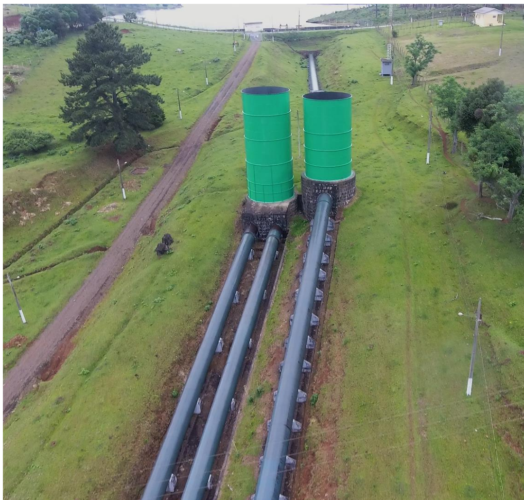
Figura 11 – Chaminés de Equilíbrio e Condutos Forçados da CGH Caveiras.
