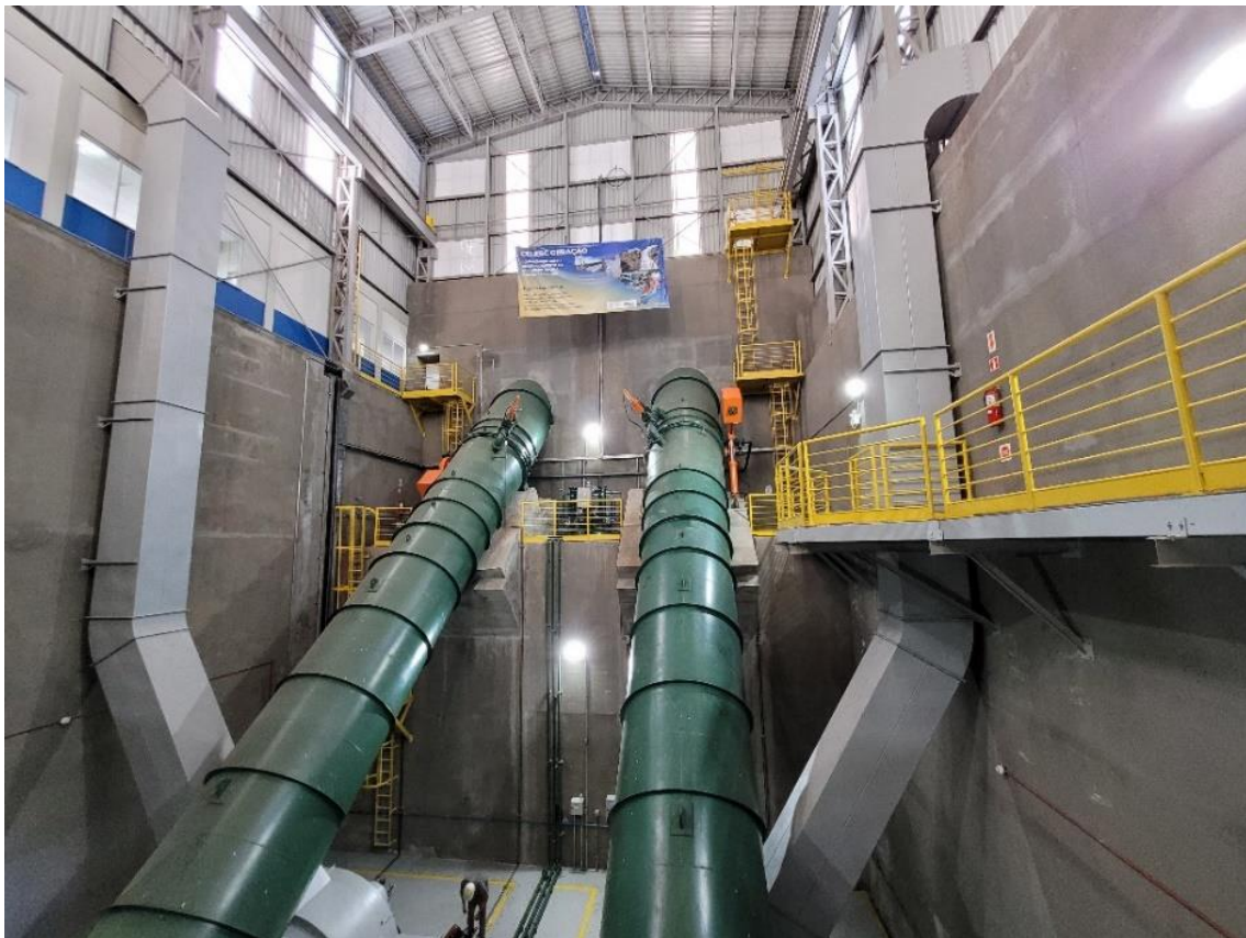
Figura 15 - Casa de Força 02.
