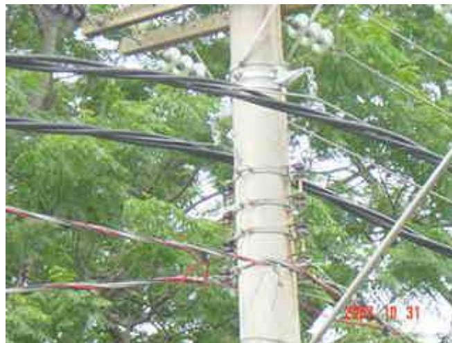
Figura 10 - Rede multiplexada de média tensão
